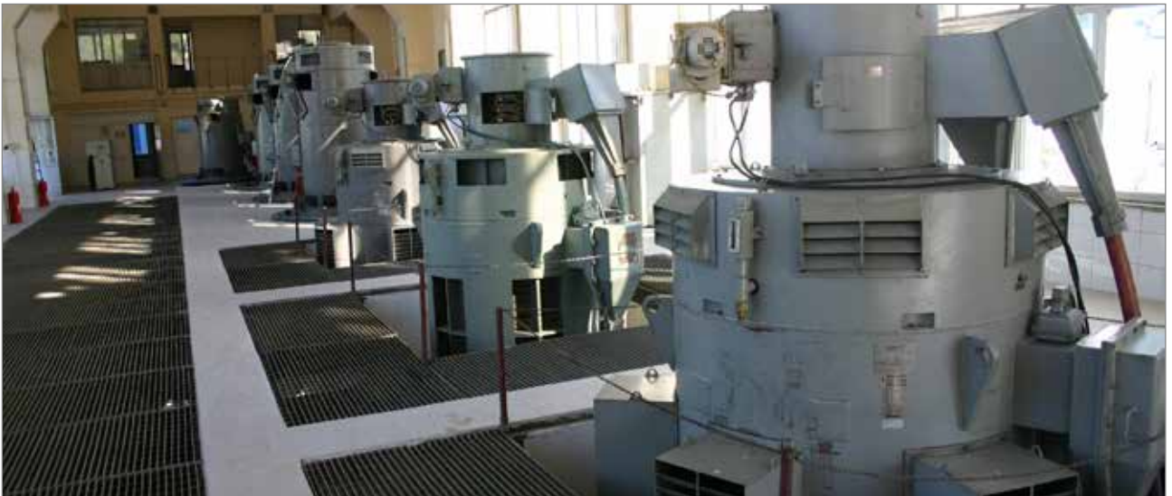
Ömerli İçme Suyu Arıtma Tesisi Hamsu Pompa İstasyonu
