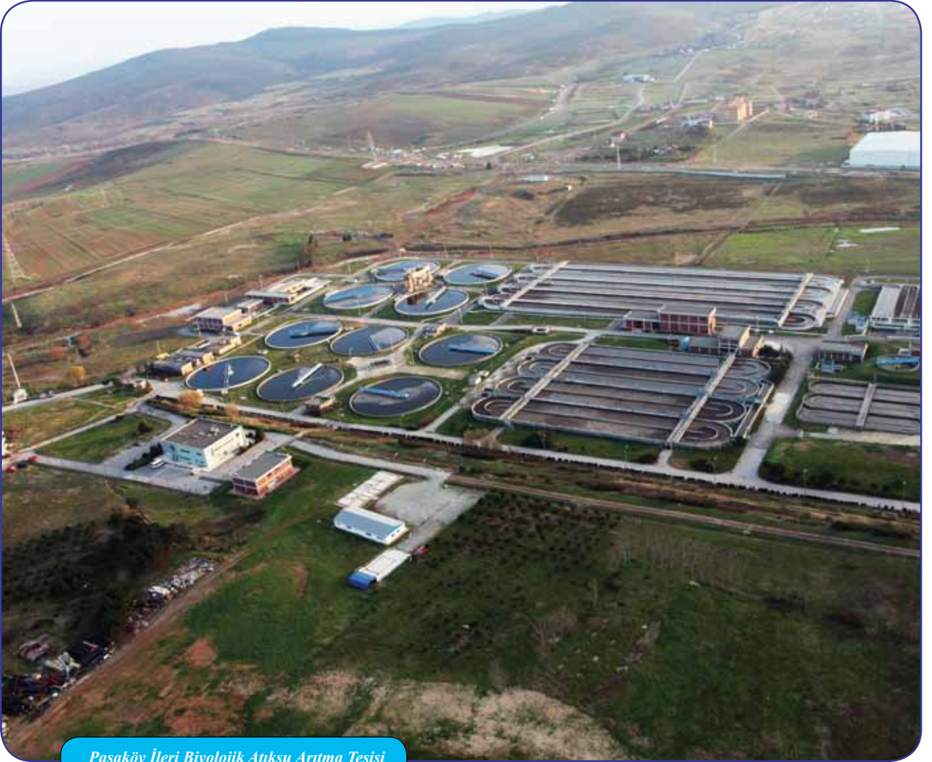
Paşaköy İleri Biyolojik Atıksu Arıtma Tesisi
