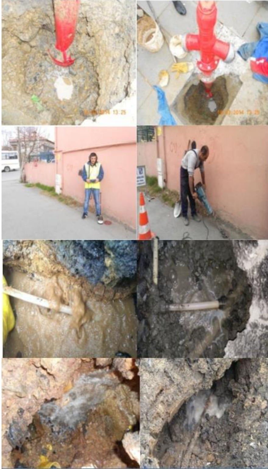
Şekil 136. Test edilen kayıp-kaçaklar-1
