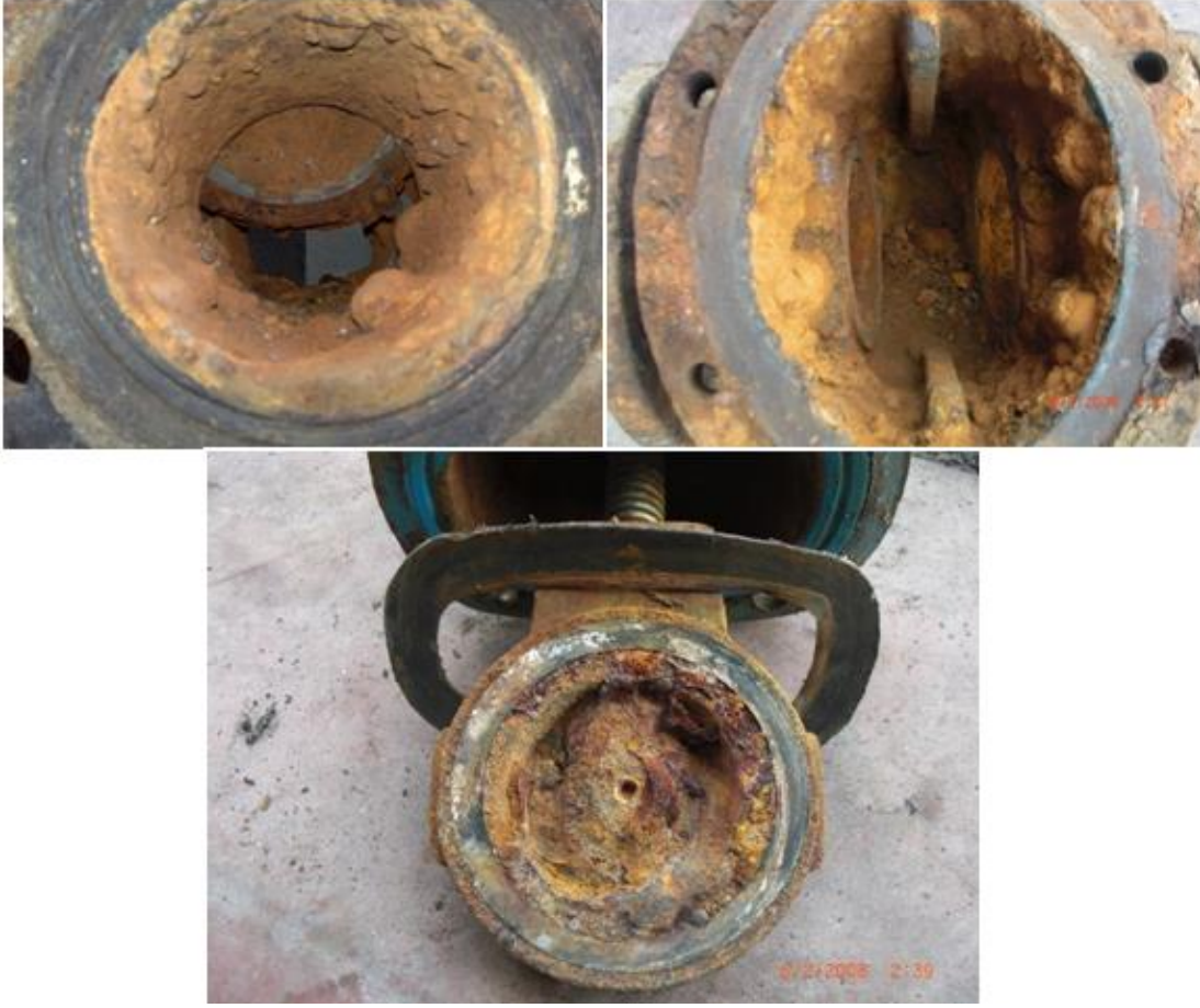
Şekil 59. Korozyona uğramış metal yataklı vanalar
