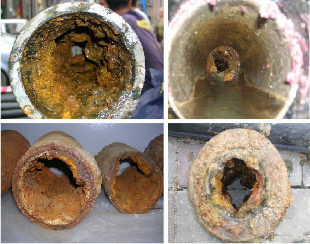
Şekil 43. İç kaplaması zamanla ortadan kalkan düktıl borulardan su metal temasına dayalı tartar ve tüberkül oluşumu
