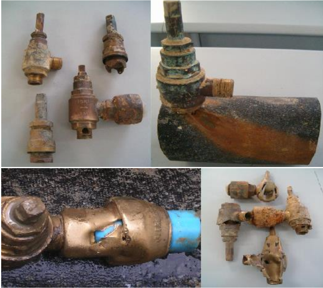
Şekil 56. Hasar görmüş pirinç malzemeler
