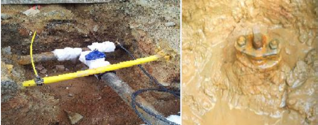
Şekil 125. CBS yazılımında görünmeyen vanaların tespit edilmesi
