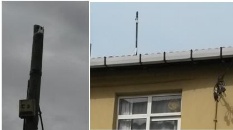
Şekil 103.Permalog sistem saha uygulaması-1
