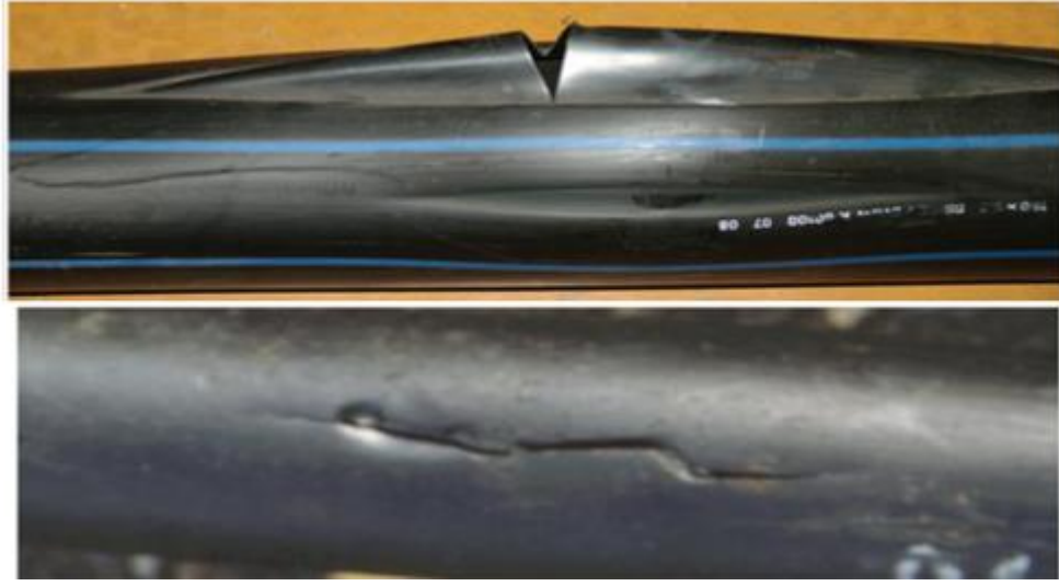
Şekil 44. Polietilen borularda oluşan hasarlar
