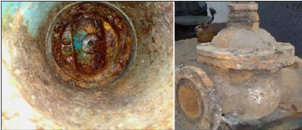
Şekil 22. Korozyona uğramış sürgülü vanalar
