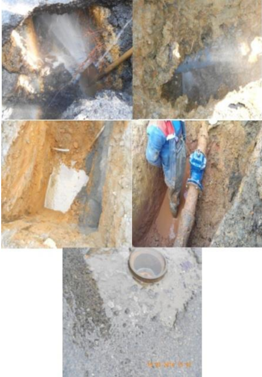
Şekil 137. Test edilen kayıp-kaçaklar-2
