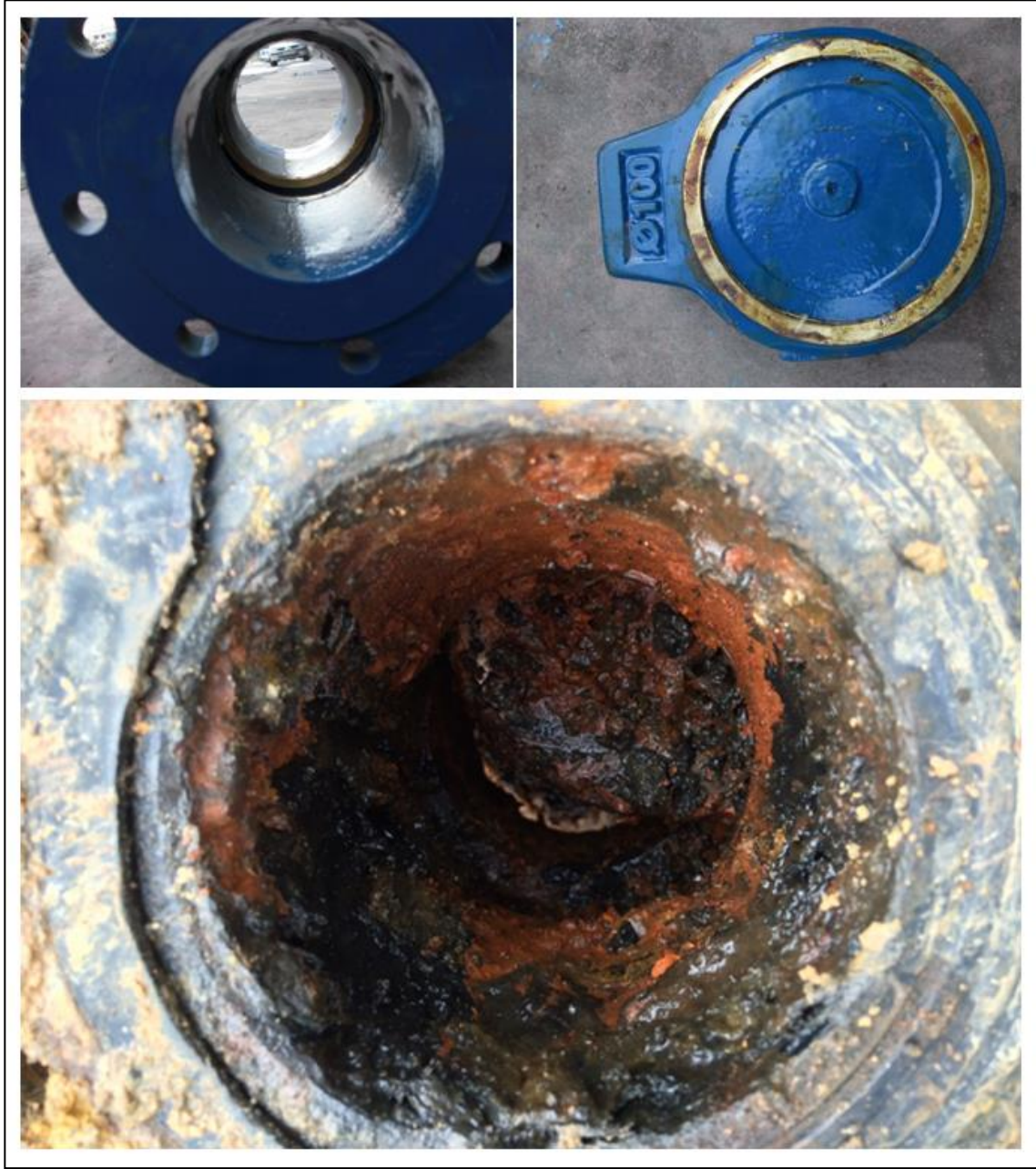
Şekil 25.Metal yataklı sürgülü vanada kullanıma dayalı oluşan tahribat
