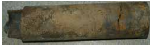
Şekil 4. Çemberel olarak kırılmış boru örneği
