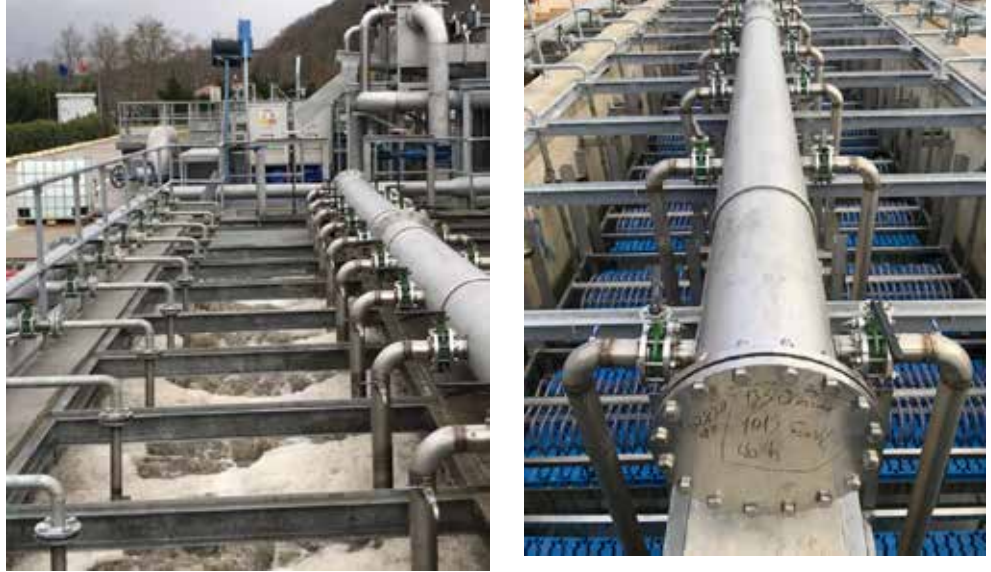
Şekil 6. GenMBR modüllerinin havuz içerisindeki görüntüleri
