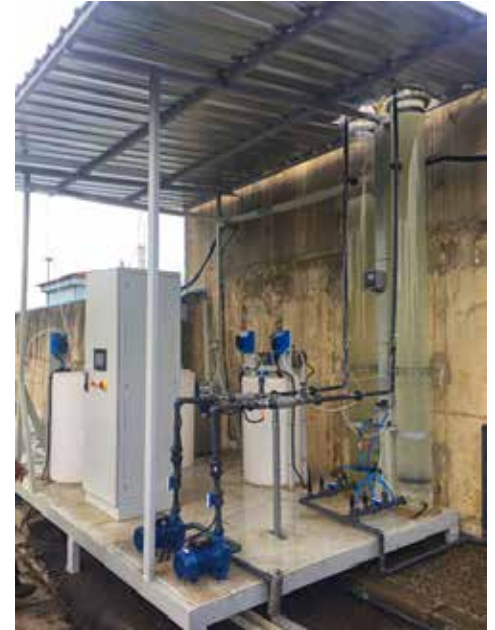
İSKİ Ömerli İçme Suyu Arıtma Tesisinde bulunan Perokson Pilot Tesisi
