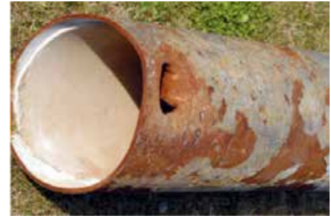
Şekil 7. Korozyon nedenli oyuk oluşumu
