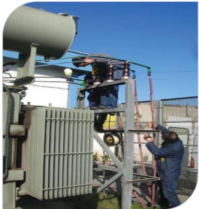
Trafoda meydana gelen arıza sonucu yapılan çalışmalar.
