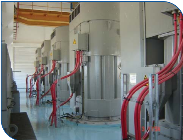
HAMSU POMPA İSTASYONU
