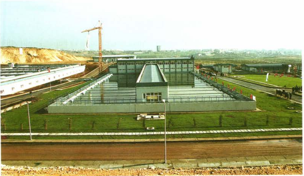
İKİTELLİ HAVALANDIRMA ÜNİTESİ GENEL GÖRÜNÜMÜ
