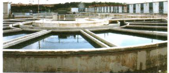
OSMANİYE TESİSİ DEGREMONT TİPİ ÇÖKTÜRME HAVUZLARI
