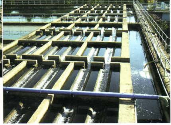
ORHANIYE TESİSİ KATLI ÇÖKTÜRME HAVUZLARI
