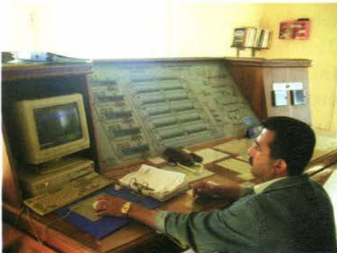
MURADIYE ARITMA TESİSİ KONTROL ODASI
