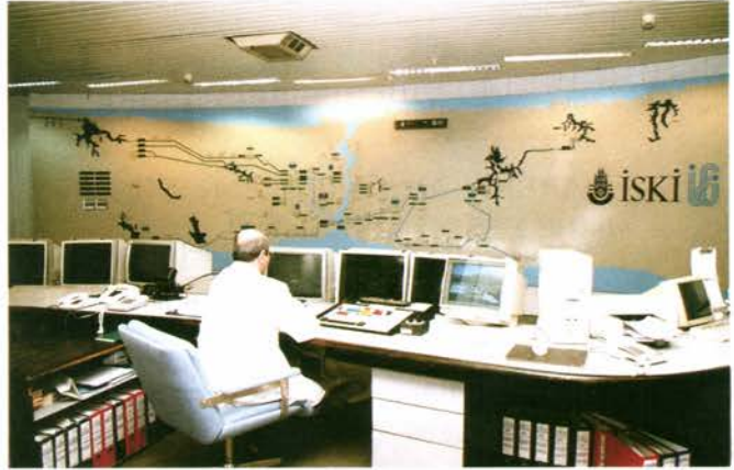
ÖMERLİ İŞLETMELERİNDE SANTRAL VE SCADA ODASI
